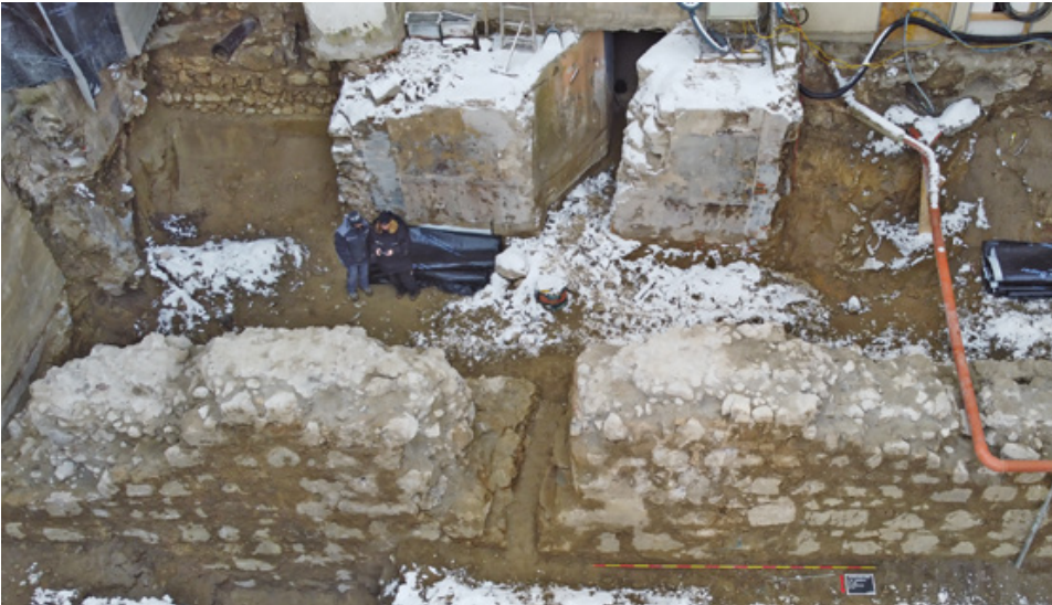
Abb. 5 Kufstein (Mnr. 83008.20.01). Frühneuzeitliche Zwingermauer (Blick von Norden); im Hintergrund der freigelegte Rest der mittelalterlichen Stadtmauer im Fundamentbereich.
