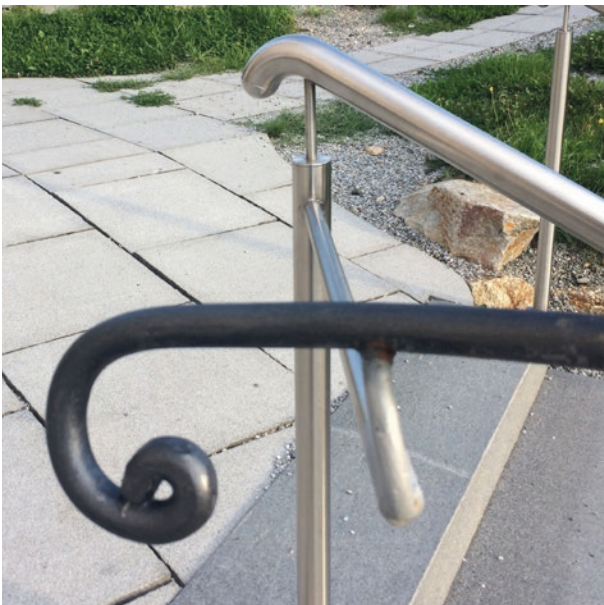
201. St. Marein, Steiermark, Frauenberg, Wallfahrtskirche Maria Rehkogel, Materialüberorientierung, Verlust von Handwerkstraditionen, Pflegeleichtigkeitsglaube: Handlaufkombination aus historischem Eisenhandlauf und neuem Edelstahlgeländer
