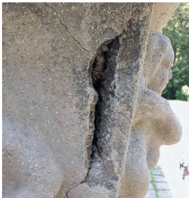
Abb. 15: Sichtbetonrelief von Anton Hanak, Schadensbild, 2021
