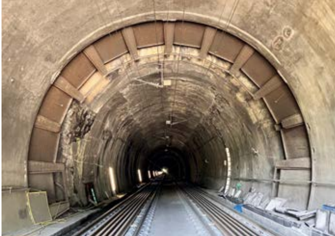
Ringdüse der historischen Belüftungsanlage im Südportal des Tauerntunnels © Bundesdenkmalamt, Foto: Stephan Bstieler
